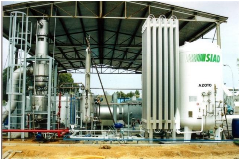
Figura 36: Impianto CFRP per la pirolisi a letto fisso
