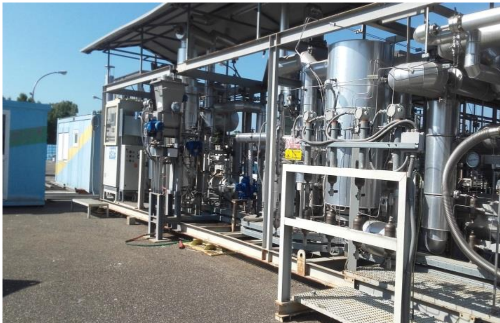
Figura 38: Impianto CFRP per la pirolisi a letto fisso
